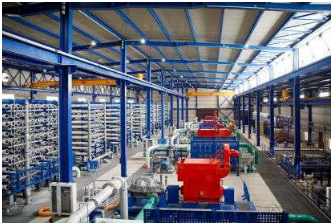
Desaladora de Almería.MARIAN LEON
